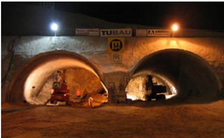
Nočný pohľad na tunel Bôrik na úseku diaľnice D1 Mengusovce - Jánovce. Je to prvý dvojúrovňový tunel na D1, stavbári ho razili novou rakúskou tunelovacou metódou NRTM.
